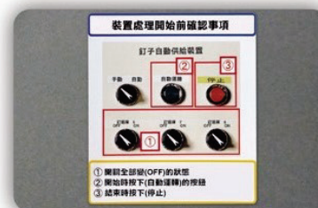
設備操作標識
